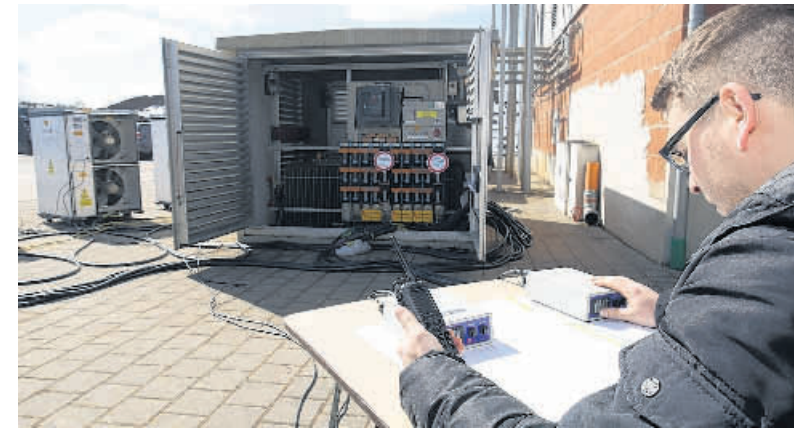
Das Projektteam untersuchte mit Lastbänken, wie sich das Inselnetz und die angeschlossenen Erzeuger – 185 Photovoltaikanlagen, zwei Wasserkraftwerke und eine Biogasanlage – bei Veränderungen der Stromlast verhalten.
